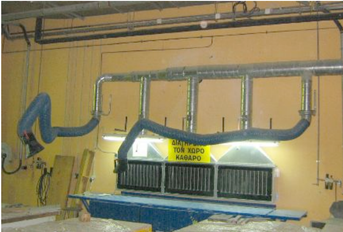
Συνδυασμός τράπεζας down draught και βραχιόνων τοπικής απαγωγής για μεγαλύτερη προστασία της ζώνης αναπνοής. Τμήμα πλαστικών - ΟΑ.- Ε.ΒΕΝΙΖΕΛΟΣ
