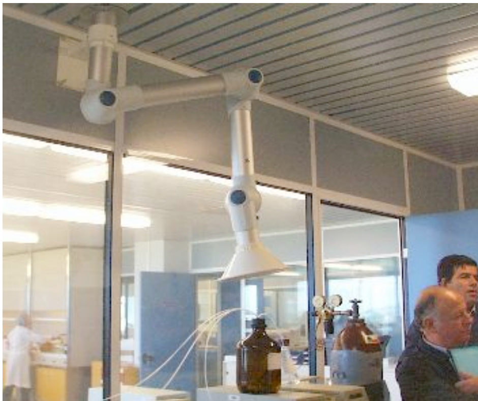
Βιομηχανία φαρμάκων BIANEΞ - Εργοστάσιο Πατρών. Απαγωγή αναθυμιάσεων
