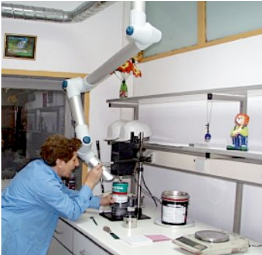
Απαγωγή αναθυμιάσεων στο Χημείο της ΧΡΩΤΕΧ ΑΕ στον Βόλο.
